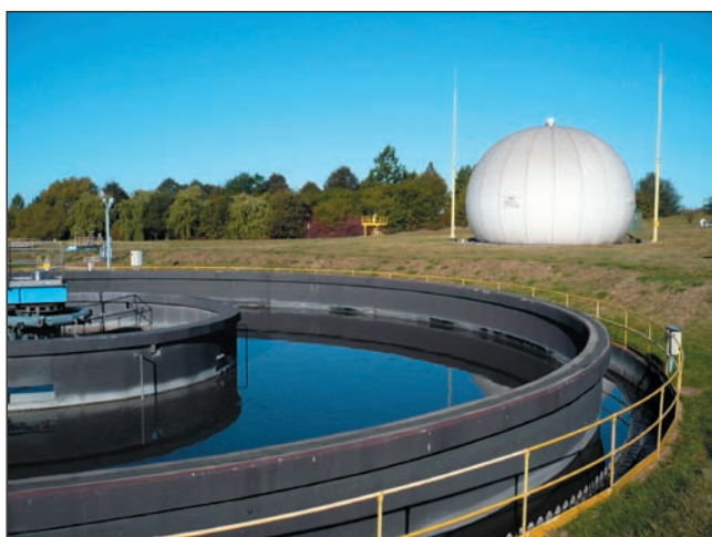
Prawidłowo działający osadnik wtórny oczyszczalni ścieków
